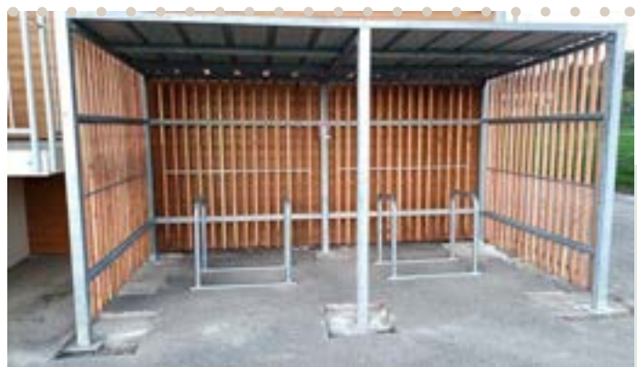
Garage à vélos salle polyvalente
