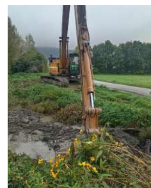
Nettoyage du piège à graviers (ruisseau de Mallein)
